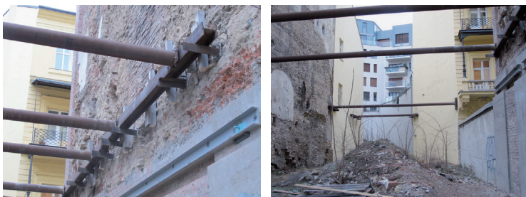
Obrázek 13a. a 13b. Praha – demolice staveb nepředstavuje jen ztrátu na historickém fondu, ale rovněž zvýšení rizika pro okolní stavby vyžadující často statické zajištění rozpěrami atd.
