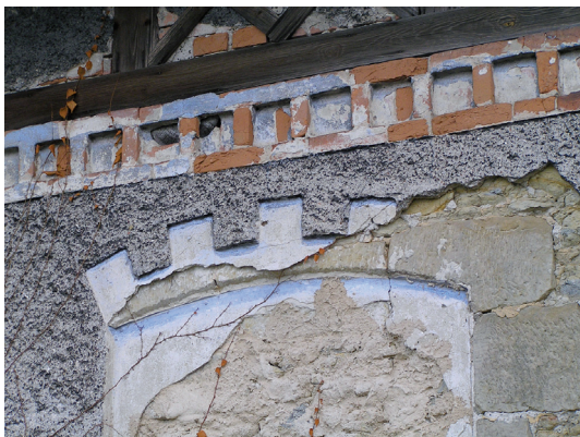
Obrázek 37. Kněžnice, okres Jičín – podélné průčelí narušené opadáním plastické omítky ze zdiva a oprýskáním náteru z cihelné římsy
