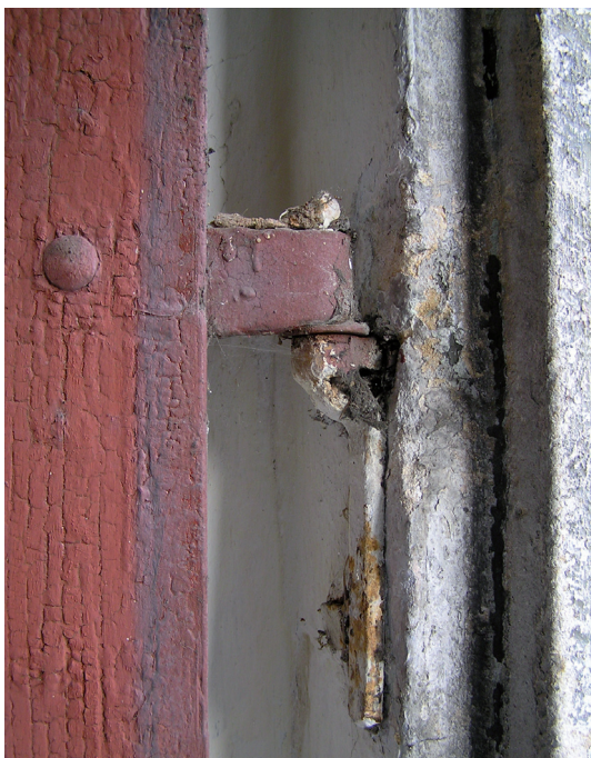
Obrázek 35. Kněžnice, okres Jičín – detail vstupních dřevěných dveří uchycený do kamenicky provedené zárubně pomocí dvojdílných vnějších závěsů. V důsledku působení povětrnosti dochází k narušení povrchových nátěrů včetně postupného nesoudržnosti s podkladem i korozi kovových prvků, přestože jsou částečně chráněny svým umístěním z rubové strany zárubně i dveřního křídla
