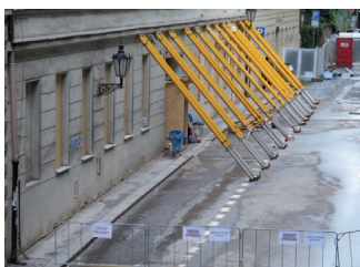
Obrázek 10. Praha – zajištění stavby v úrovni stropní konstrukce po výbuchu plynu, představujícího mimořádné ohrožení pro obyvatele i stavby
