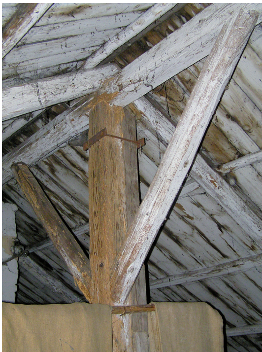
Obrázek 39. Kněžnice, okres Jičín – pohled do hřebene s vrcholovou vaznicí vynášenou sloupkem a zavětrovacími pásky. V důsledku vápenného nátěru plnicího rovněž konzervační funkci dřeva jsou dobře patrná místa zatékání, tj. od hřebene a spár mezi prkny. Dřevěný sloupek sepnut v horní části kovovou obručí
