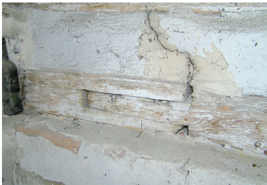
Obrázek 41. Kněžnice, okres Jičín – trhlina ve zdivu, projevující se v místě tesářského spoje pozednice. Charakter spoje dovolil vznik tahového napětí, které nebylo zdivo schopné přenést
