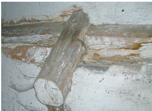
Obrázek 40. Kněžnice, okres Jičín – detail odřezané šikmé vzpěry/táhla (podle kombinace zatížení), plnicí zavětrovací funkci subtilní hrázděné na dezdivky
