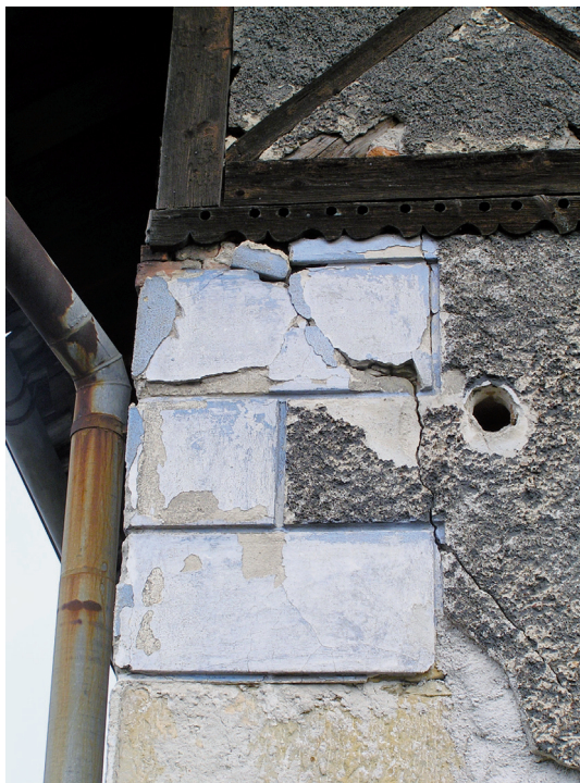
Obrázek 36. Kněžnice, okres Jičín – nároží domu porušené trhlinou v pravděpodobném důsledku změn v základové spáře. Na těchto se zpravidla podílí podmáčení (okapní svod) i otřesy od silniční dopravy (komunikace v těsné blízkosti)
