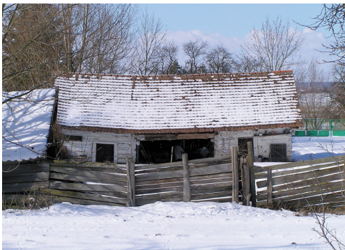
Obrázek 18. Libeň, okres Hradec Králové - příklad deformace roubené konstrukce hospodářské stavby
