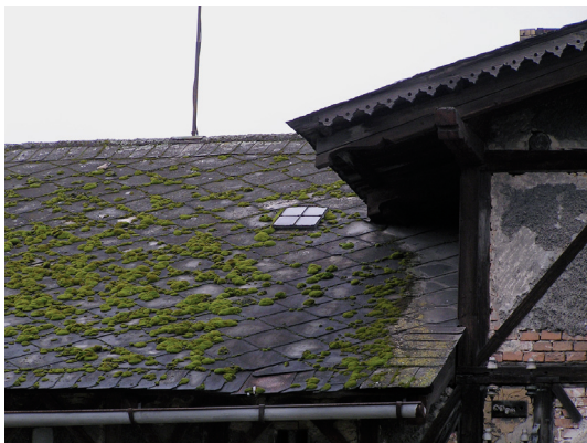
Obrázek 43. Kněžnice, okres Jičín – vaznicová střešní konstrukce s vláknocementovými šablonami, pokrytými mechem a lišejníkem s výjimkou místa vyznačujícího se zvýšenými odvodem dešťové vody ze stříšky podkrovní světničky
