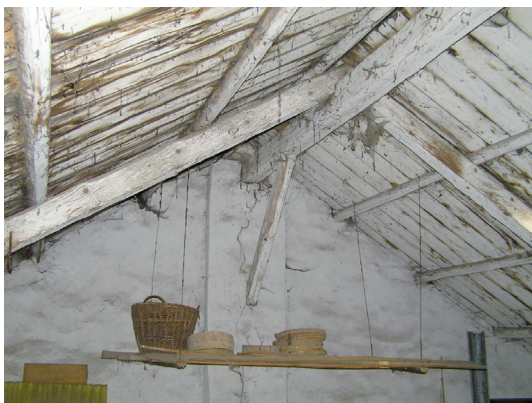
Obrázek 44. Kněžnice, okres Jičín – půdní prostor s vlhkostními mapy, dobře patrnými i v důsledku provedení vápenného nátěru na nosných i nenosných prvcích vaznicového krovu, tj. krokví, vaznic i prkenného bednění pod vláknocementovými šablonami
