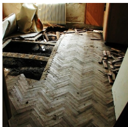
Flessione di un solaio in legno.
