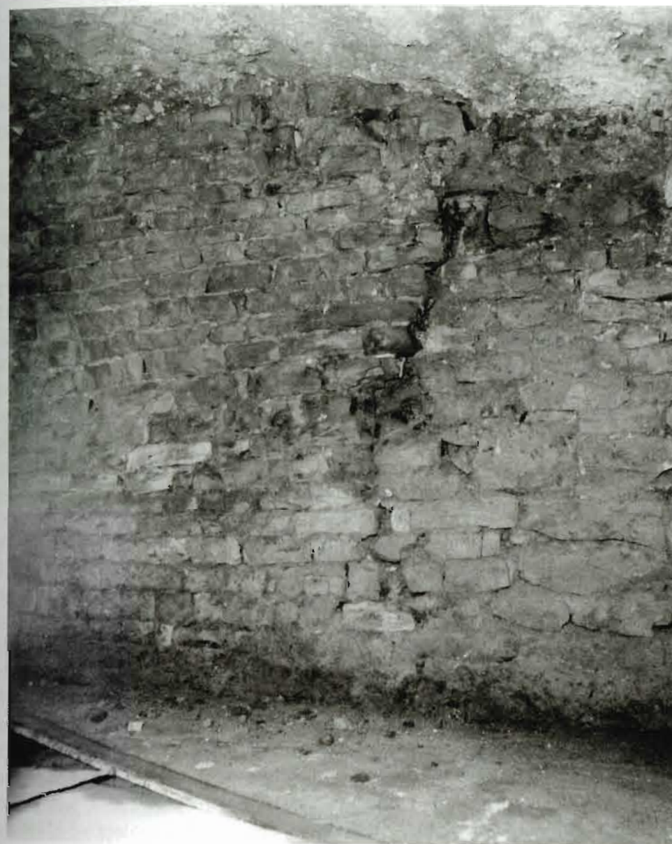
Obr. 10: Část vnějšího líce východního úseku románské hradby s trhlinou. Foto J. Sloup.
