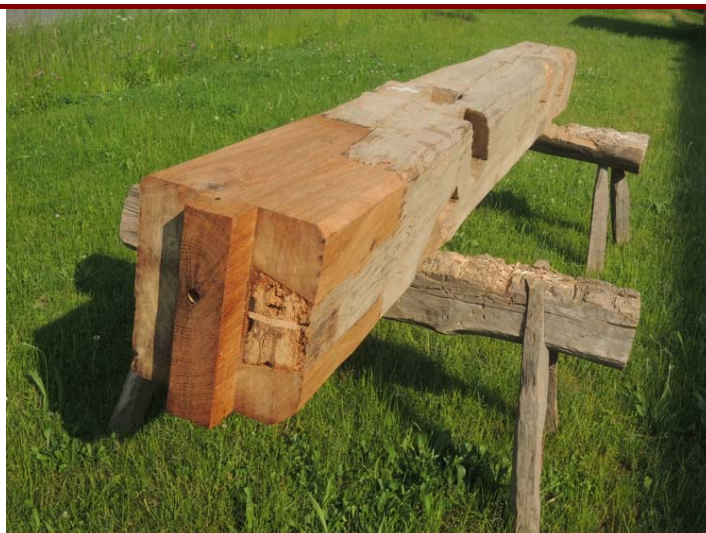
Vlevo: Celkový pohled na poškození sloupku ve spodní části prvku
