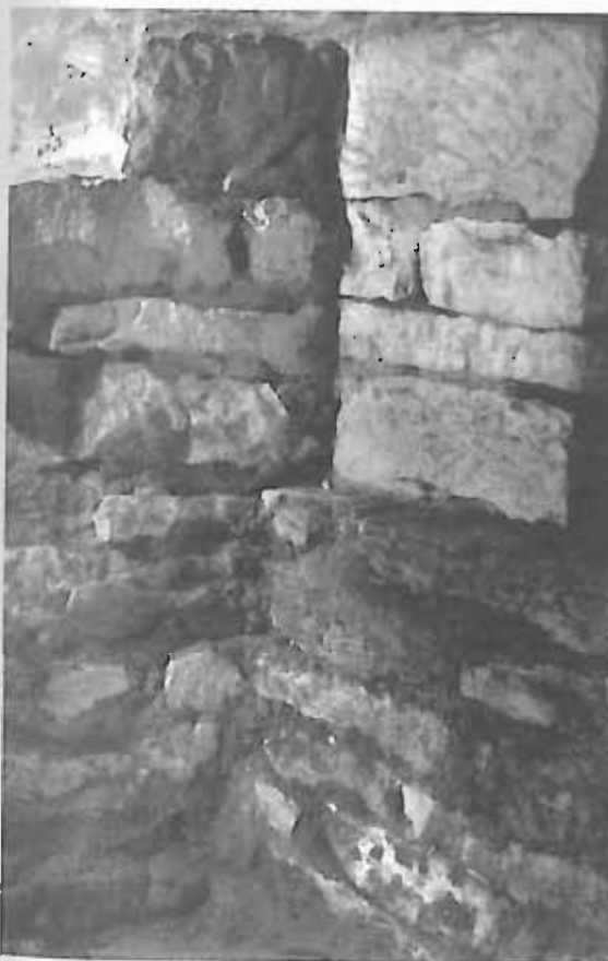
Obr. 4/50: Chrám sv. Víta, kaple sv. Václava. Detail napojení vnějšího prstence zdiva jižní apsidy rotundy (vpravo) na dochovanou část lodí rotundy (vlevo). Patmo základové i nadzemní zdivo (oddělené ústupkem), z nadzemní části apsidy patrna jen lizéna. Pohled od jihozápadu.
