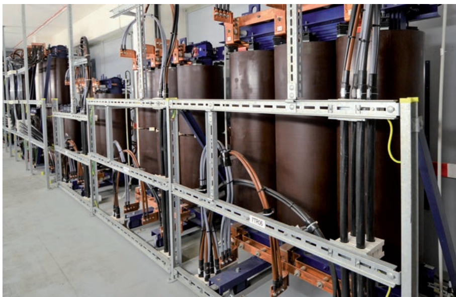
Obr. 7 Transformátory napájecího systému [3]
