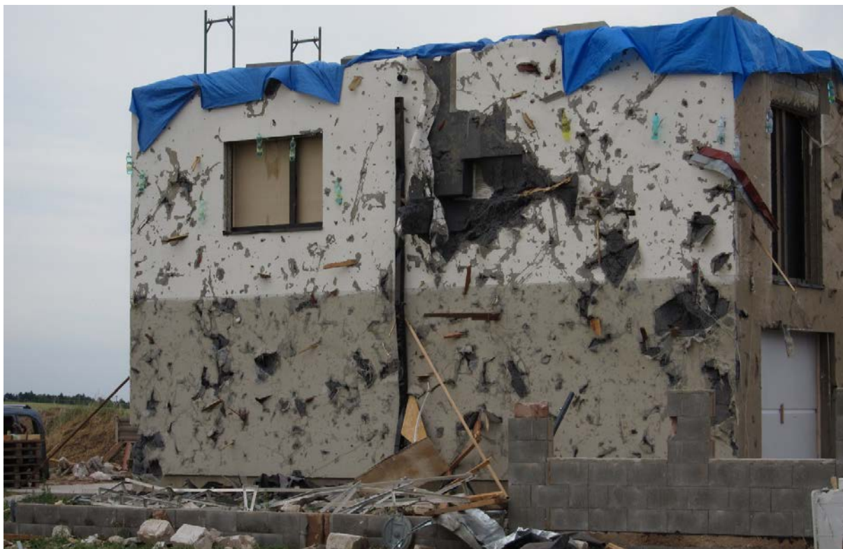
Obr. 32 Ukázka působení rychle letících projektilů zaražených do stěn poničené budovy. Právě tyto letící předměty i při menších rozměrech představují jedno z největších rizik při tornádu. Při velké rychlosti mohou prolétat okny nebo i tenčími stěnami a ohrožovat osoby uvnitř zasažených domů. Foto: David Rýva.
