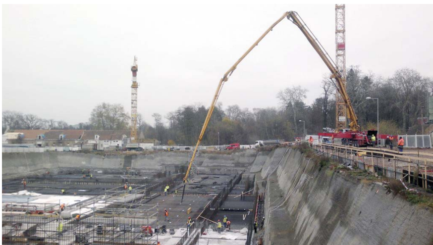
■ Obr. 3 Stavba laserového centra ELI-Beamlines v Dolních Břežanech – betonáž základové desky laserové haly (listopad 2013).
