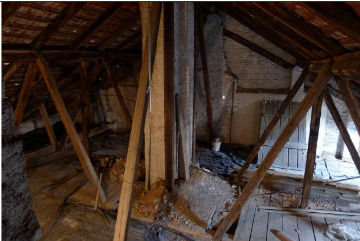
Krov domu čp. 414/I v Praze. Pohled na prostoru podkroví s krovem vaznicové konstrukce.
