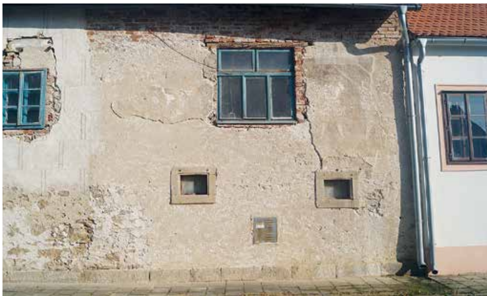
6 Slavonice, dům čp. 545. Stav před rekonstrukcí části fasády s motivem landsknechtů. Po stranách druhotně proraženého okna jsou již zakonzervované fragmenty původního renesančního sgrafita. Sgrafitová bosáž na levé straně snímku patří k pozdější renesanční výzdobě domu; foto 2017.
