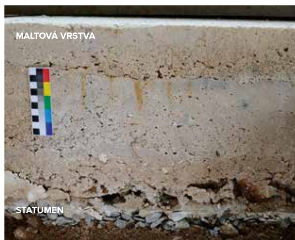
26 Řez jednovrstvou maltovou podlahou zhotovenou podle vzorku podlahy z rotundy sv. Víta.
