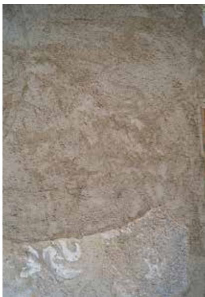
19 První vrstva barevného intonaca nanesená zednickou lžící a poté srovnaná její hranou.
