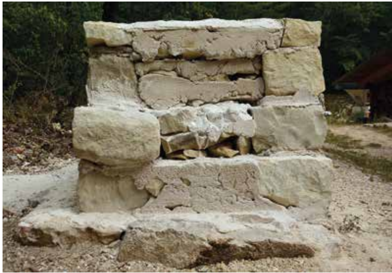
15 Pohled na jádro zdiva vyplňované po řádcích. Druhý a třetí řádek od spodu vykazují zjevně nedostatečné vyplnění vnitřních mezer. Pouze velmi tekutá malta dokázala kvalitně vnitřní prostor mezi kameny vyplnit.
