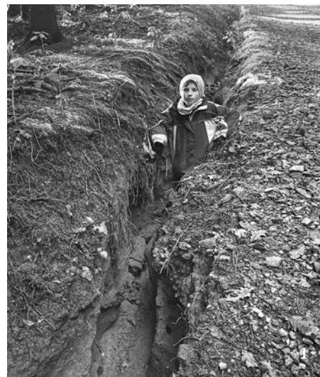
1 Až metr hluboká může být erozní rýha vymletá proudem tekoucí vody v zářezu lesní cesty, která ukazuje na špatné odvodnění komunikace a ochranu půdy před přívalovými srážkami. Foto T. Kučera
