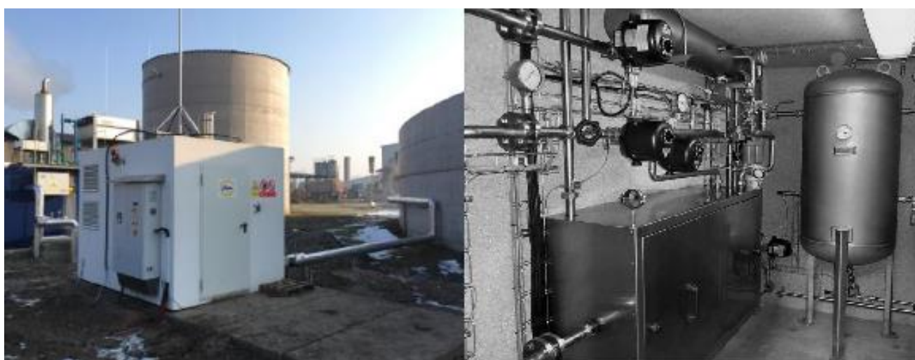
Zařízení na čištění bioplynu nacházející se na bioplynové farmě Choťovice
