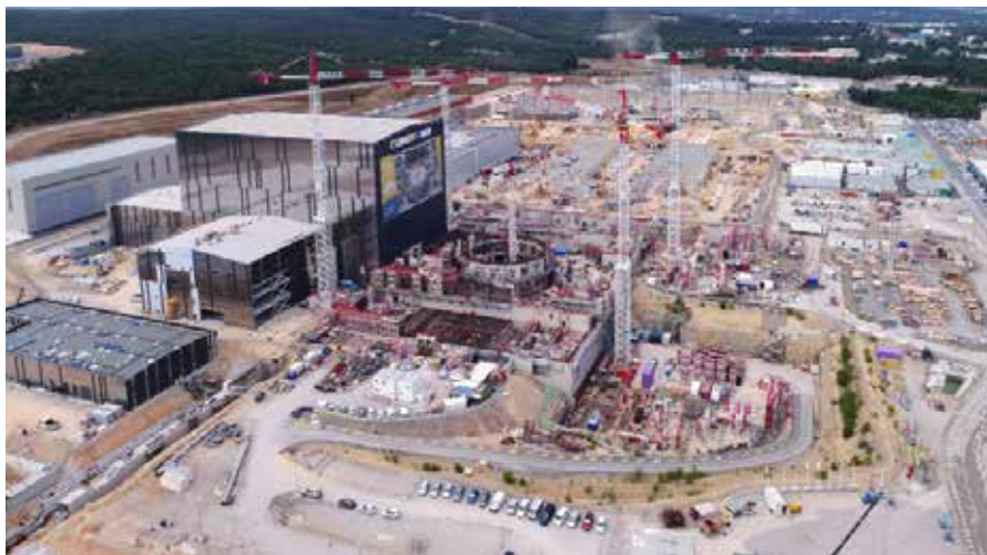
Tokamak ITER v jihofrancouzském Cadarache by se měl stát předstupněm ke komerčnímu využití termionukleární fúze. Celkový rozpočet největšího vědeckého projektu na světě činí 18 miliard eur.
