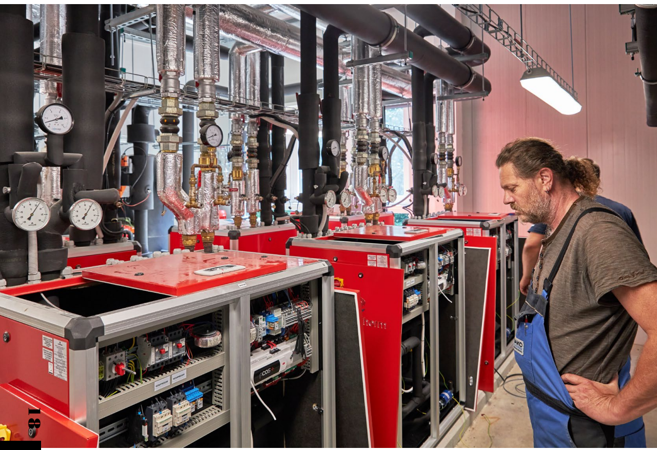
Obr. 5: Strojovna zabírající celé jedno patro nové budovy využívá nejmodernější metody rekuperace odpadního tepla
