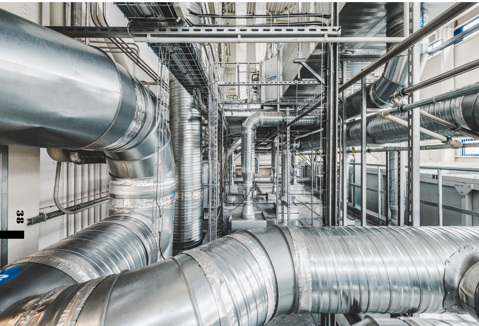
Obr.4: Část systému vzduchotechniky |
